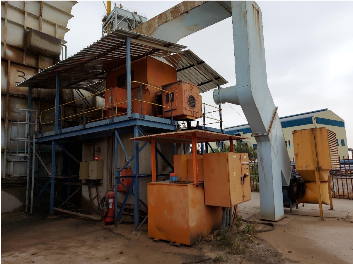
Figure: Surface fan motor 4
