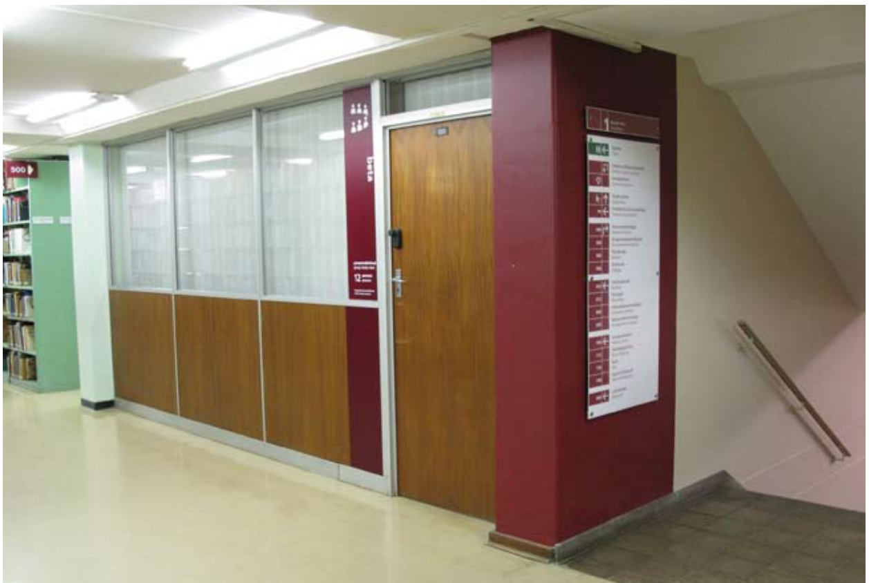
Figuur 4.41: Voor en na installering van vloergidse en identifiserende teken vir die beta-groepstudielokaal op die eerstevloer van die biblioteek.
