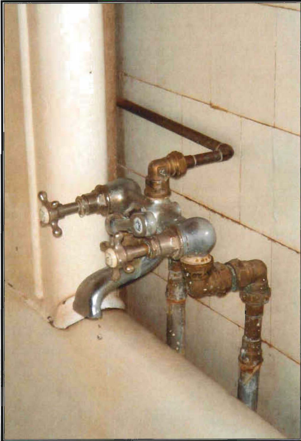
Illustrasie 73 Die warmwaterpyp was van koper. Al die waterpype is sigbaar en loop langs die muur. 486
