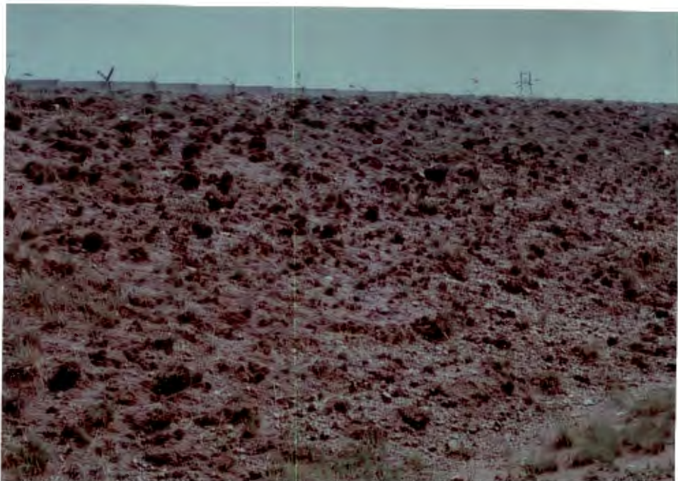
Plaat 3.15: Erodering van bogrond teen 'n te steil snyhelling waar geen waterbeheer toegepas is nie.
