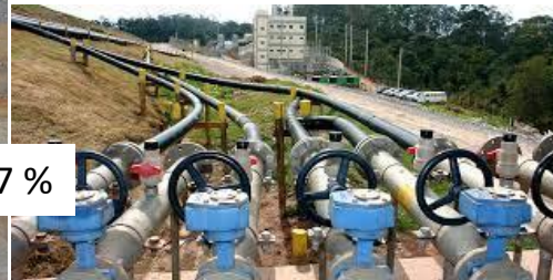
Landfill gas collection
