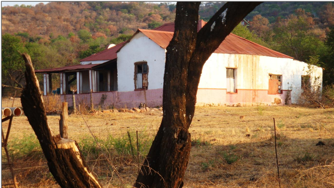
Figuur 56: Waterskade by Bet-El se opstal 196
