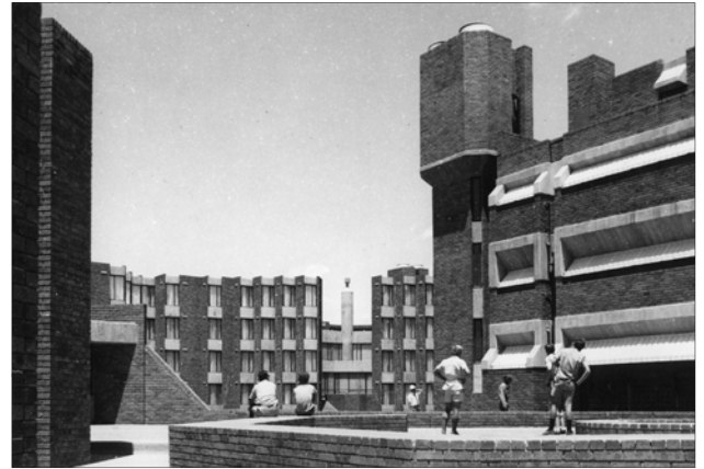
Die Kasteel-kompleks in aanbou. Op die agtergrond is die fundamente van Vergeet-my-nie en Wag-n-bietjie reeds voltooi (Bron: PUK-Argief)
